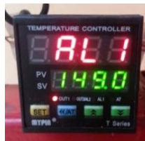
Figura 6.21 Seteo de la temperatura a controlar. Fuente: Pablo Tirado.
