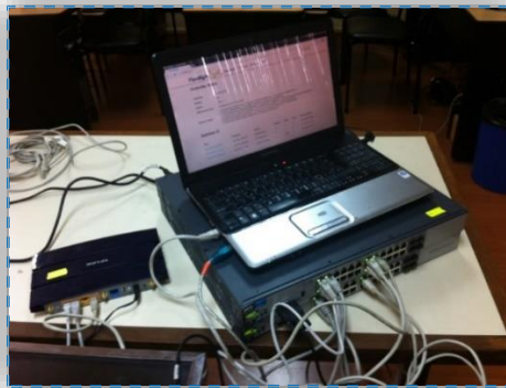
Fig. 4. 60 Switches utilizados en la infraestructura de red
