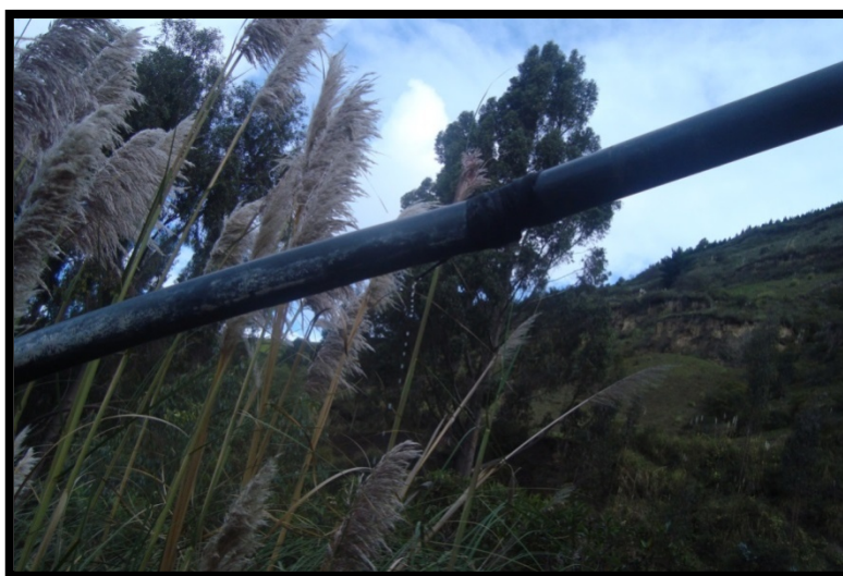
Fotografía 2.- Red de la conducción de la comunidad de Nitilusa Rumipamba. Tubería en mal estado por ende existe contaminación
