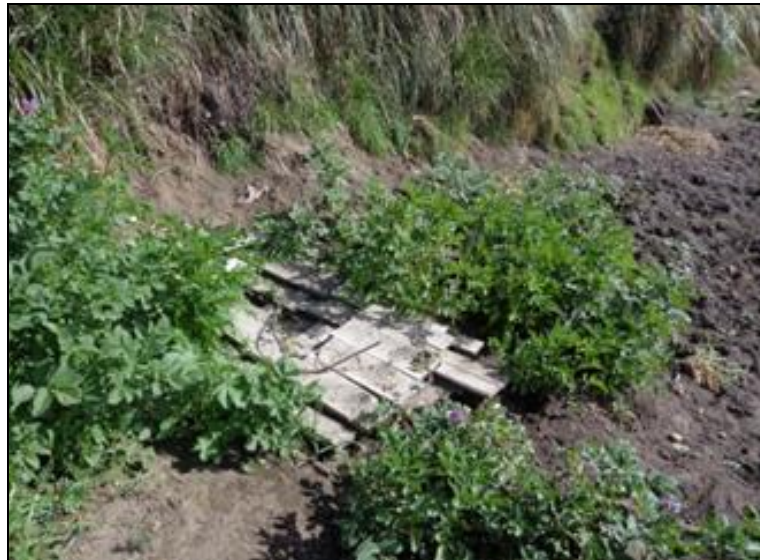
Foto 4. Pozo Séptico dentro de la vivienda.
