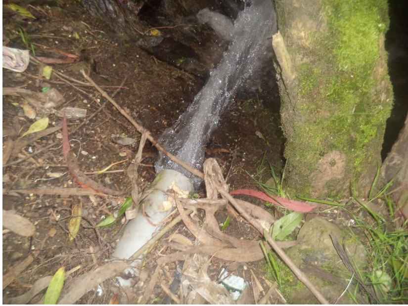
Descarga directo de aguas residuales al Río
