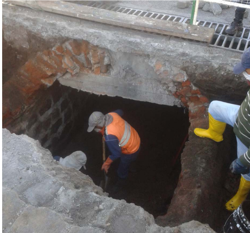
Ilustración 20: Colapso de un tramo del colector sanitario El Tumbé
