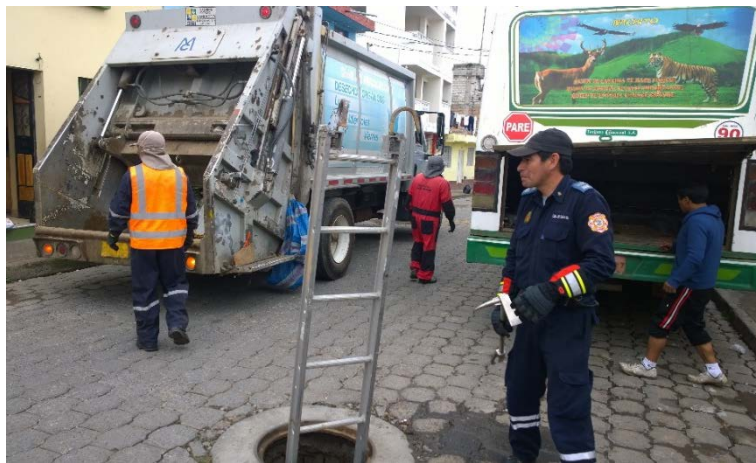
Ilustración 11: Carga de vehículos pesados sobre el colector sanitario
