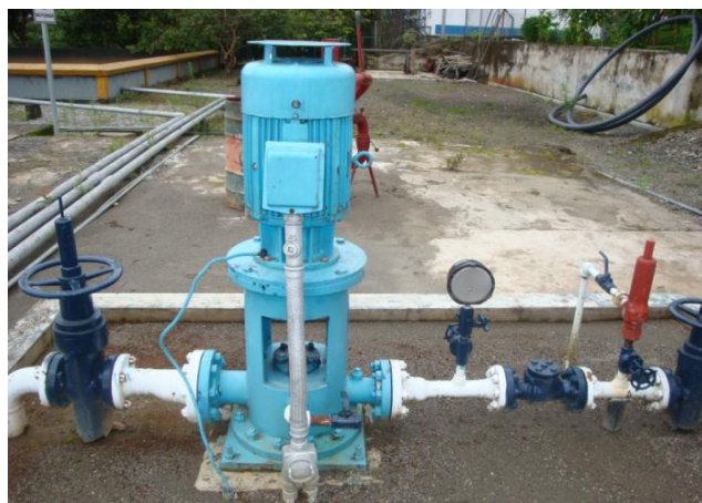
Foto N° 2.13: Bomba de transferencia
