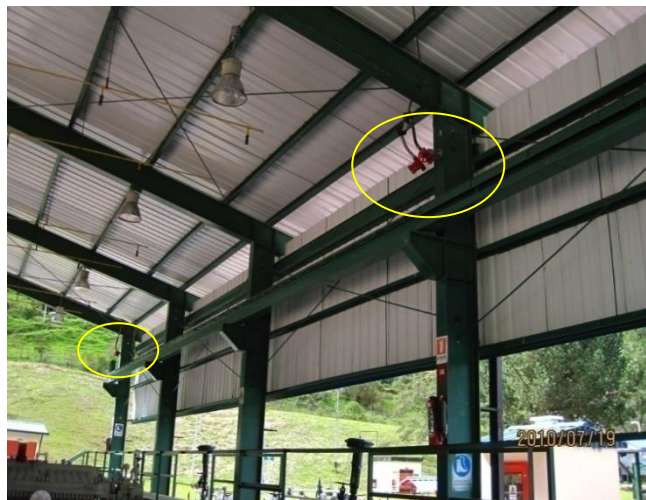
Foto N° 2.8: Detección de gas y fuego
