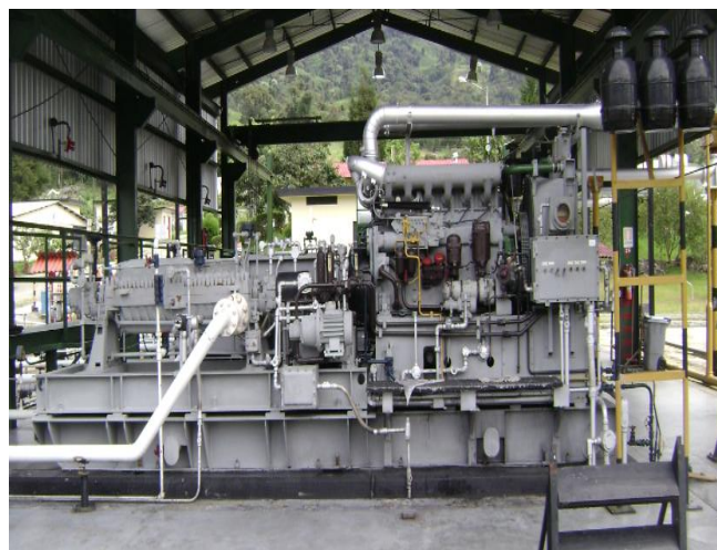
Foto N° 2.11: Grupos de Bombeo
