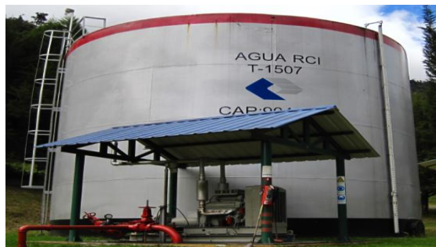
Foto N° 2.6: Tanque de almacenamiento de agua
