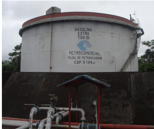
Foto N° 2.1: Tanque de techo flotante para almacenamiento de gasolina base
