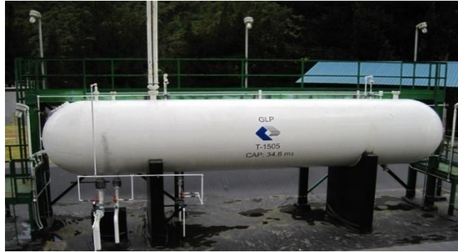
Foto N° 2.5: Tanque de Bullet tipo salchicha
