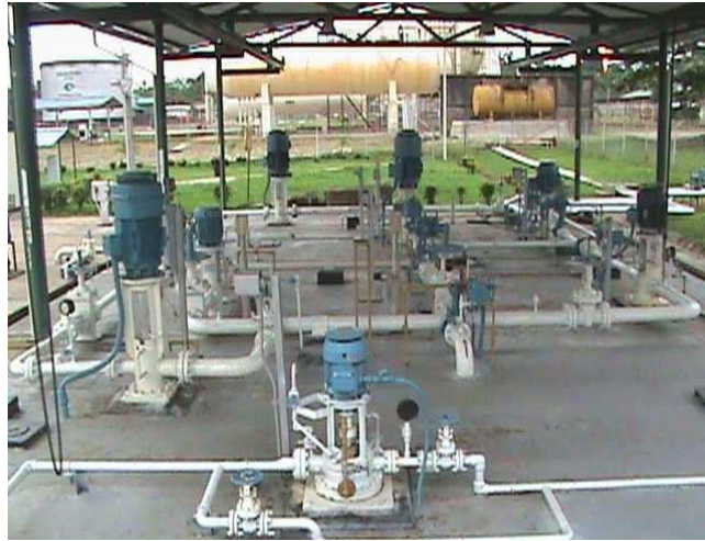
Foto N° 2.10: Área de Bombas Boosters
