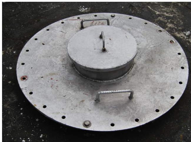
Foto N° 2.4: Tanque de Sumidero
