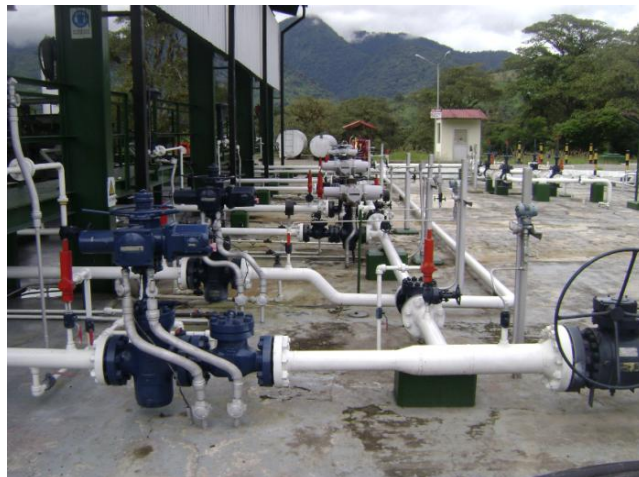
Foto N° 2.15: Manifold de Válvulas
