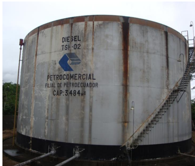
Foto N° 2.2: Tanque de techo fijo para almacenamiento de diesel 2
