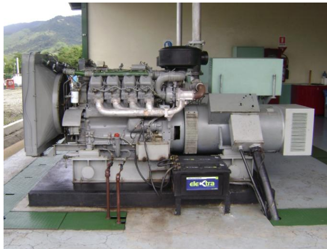
Foto N° 2.18: Generador de Energía Eléctrica
