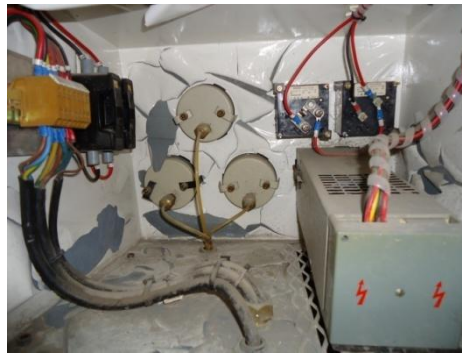
Conexiones rotas y pintura descascarada.
