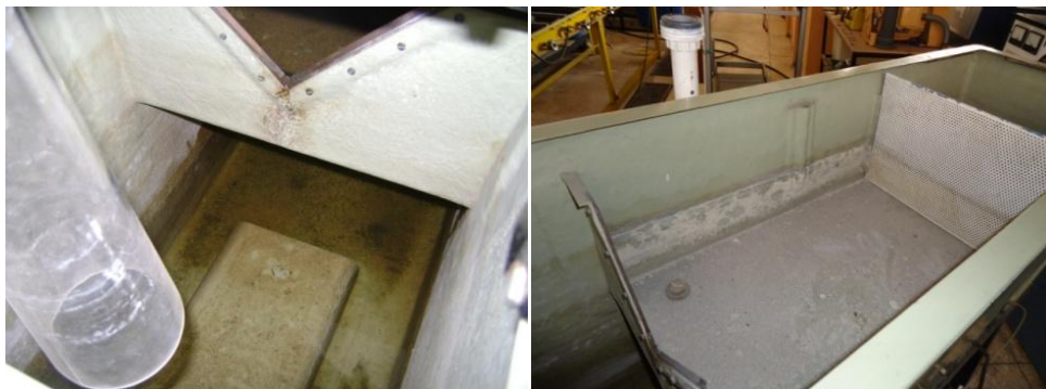
Tanque en mal estado
