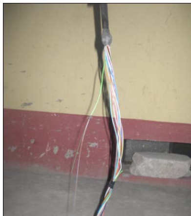
Figura 6.22: Fibra óptica de 48 hilos
