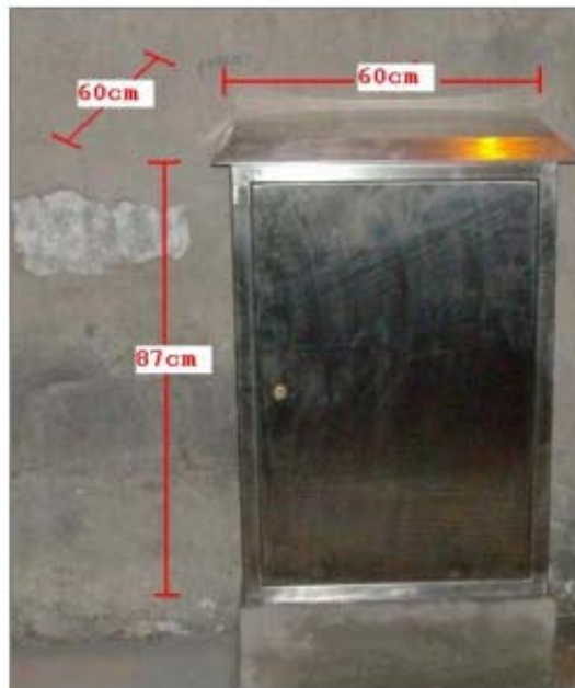
Figura 6.18: Caja o armario de distribución
