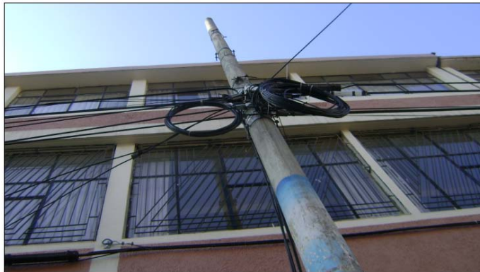
Figura 6.10: Mangas de cables de FO sobre postes
