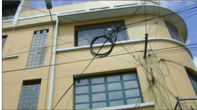
Figura 6.9: Cables de FO colgados
