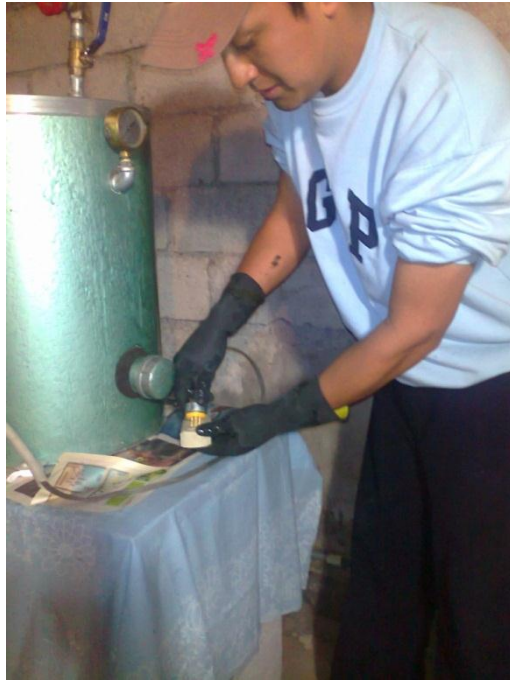
Conectado a la energía eléctrica
