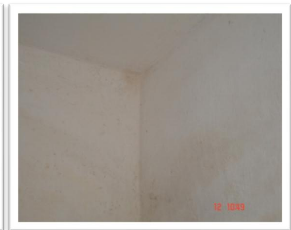
Fig.I.4 Aparición de hongos (manchas) en paredes
