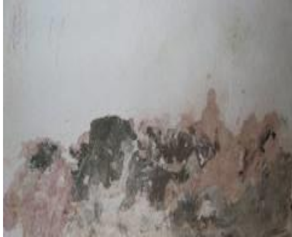
Fotografía N°8 Coloración intensa en paredes. Perdida total del color y estucado de paredes.
