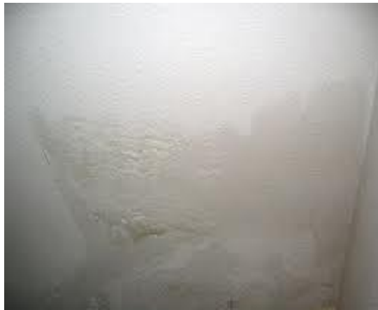
Fotografía N°6 Mancha oscura en la pared (Inicio de humedad en paredes)
