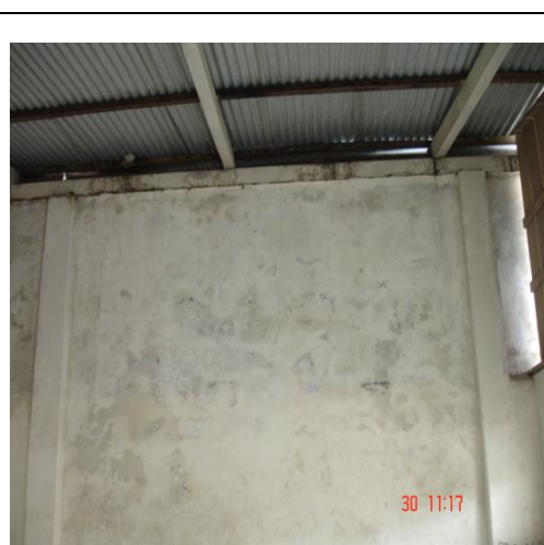
N°3)Filtración de agua en la parte superior
