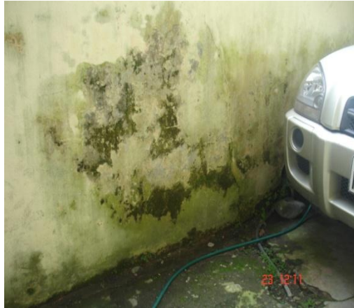
N°1). Muro con humedad ascendente
