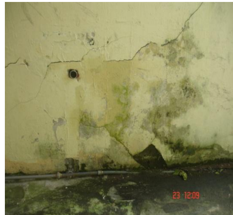
N°2). Pared afectada por filtraciones
