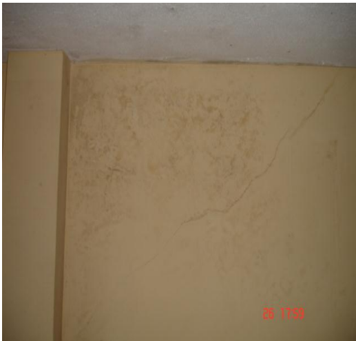
Foto 3. Humedad por filtración en paredes etapa inicial
