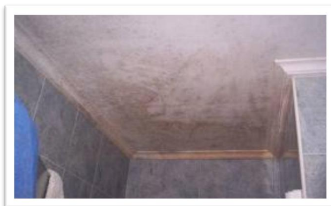
Fig.II.8. Humedad por Condensación
