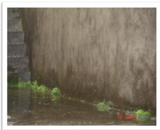
Fig.I.3 Empozamiento de agua
