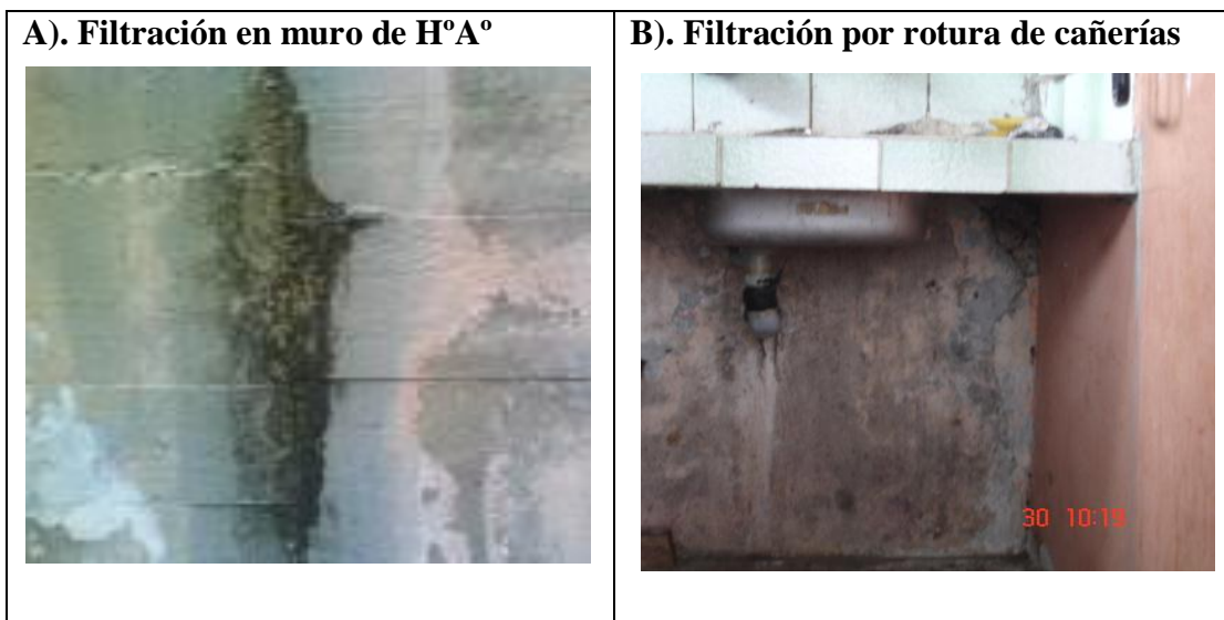
Imagen.6.7.3.1. Fotografía A y B Problemas ocasionados por la Humedad por Filtración
