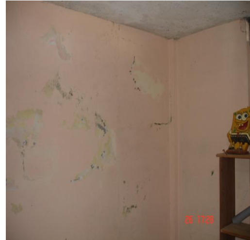
Foto 4. Humedad por filtración en paredes etapa media
