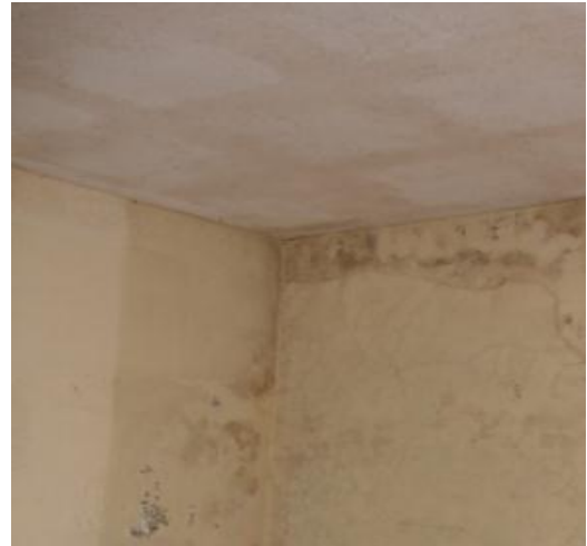
Foto 6. Humedad por filtración en losa de cubierta y paredes
