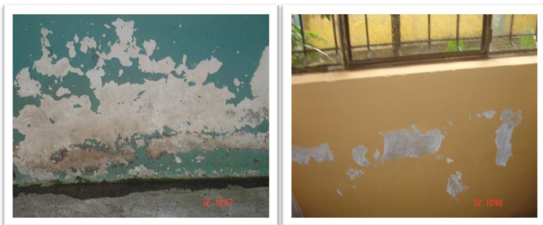
Fig.III.1 Juntas mal realizadas
