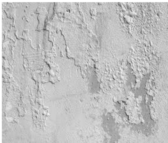
Fotografía. N°7 Desmembración de pintura en paredes.
