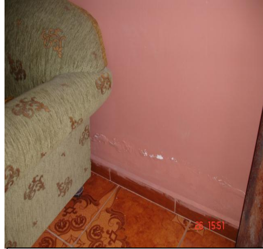
Foto 1. Humedad por capilaridad en el interior de vivienda
