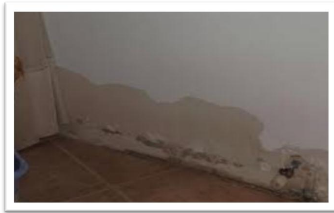
Fig.II.7. Humedad por Capilaridad
