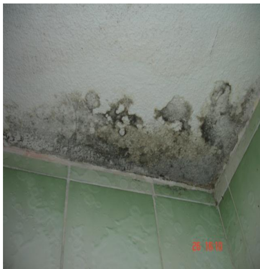
Foto 7. Humedad por condensación en ducha
