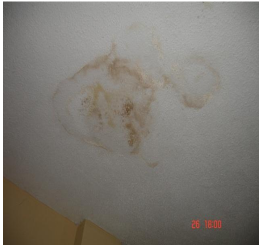
Foto 5. Humedad por filtración en losa de cubierta
