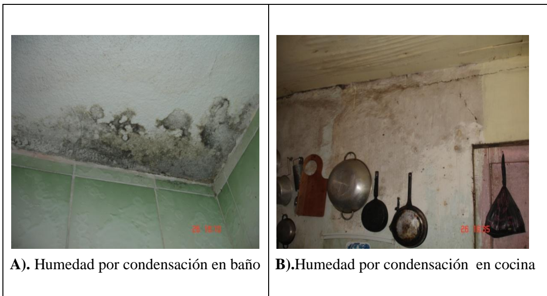
Imagen.6.7.4.1. Fotografía A y B Problemas ocasionados por Humedad por condensación
