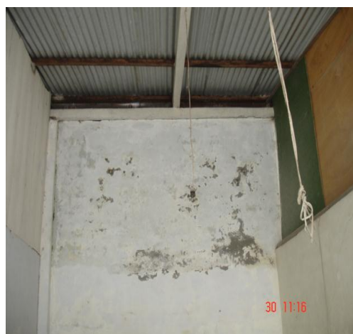
N°4)Grietas en la parte central de la mampostería
