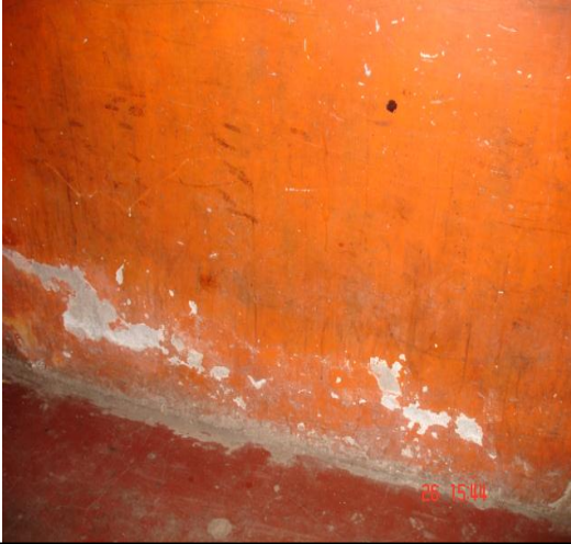
Foto 1. Humedad por capilaridad en patio exterior de vivienda
