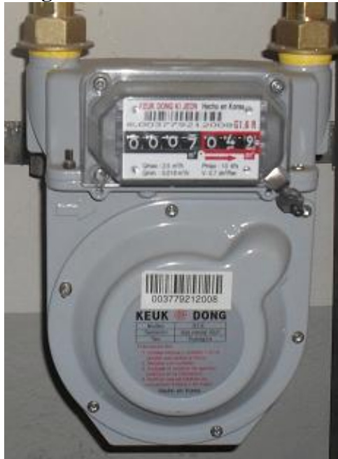
Figura 3-2: MEDIDOR DE GAS
