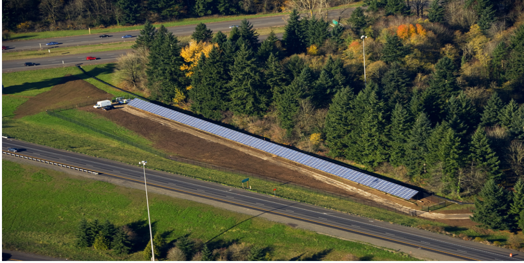
Figura 2.25: Sistema fotovoltaico en Oregon [30].
