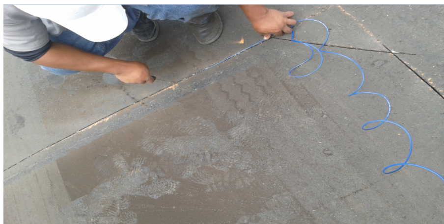
Figura 2.70: Instalación de un lazo de inducción [fuente propia]
