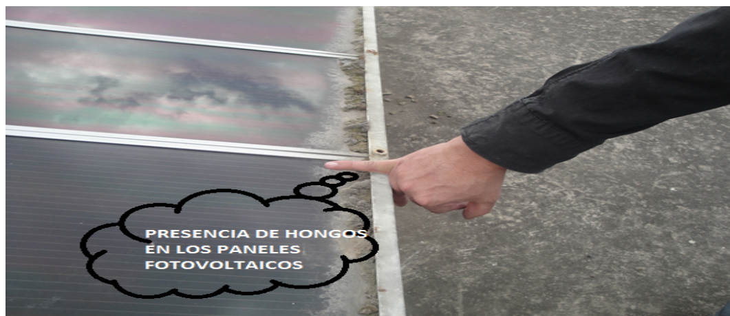
Figura 4.14: Paneles fotovoltaicos con hongos [fuente propia]
