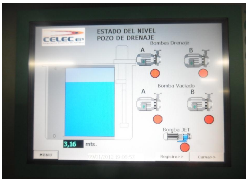
Figura 4.80 Bombas de drenaje/Vaciado y JET encendidas
