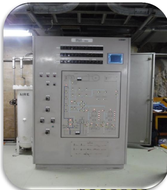
Figura 4.48: Tablero con la HMI instalada.
