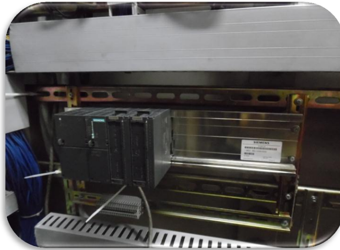
Figura 4.51: PLC instalado en el rack.
