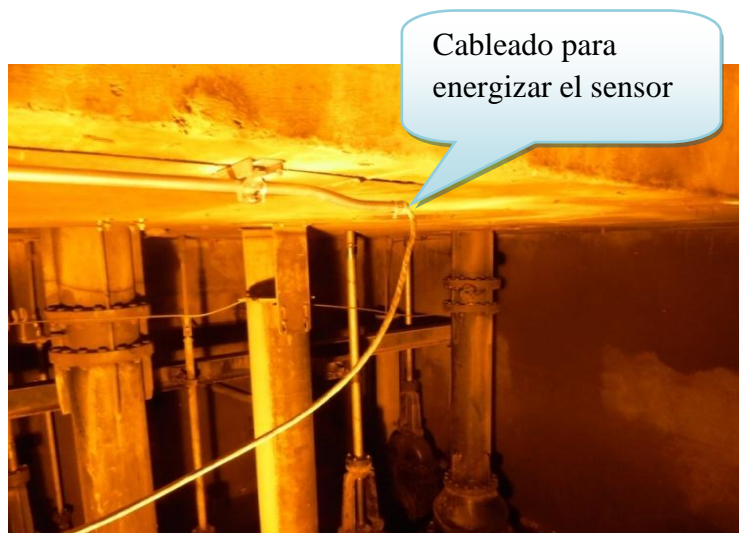
Figura 4.82: Pozo de drenaje con el cableado para el sensor
