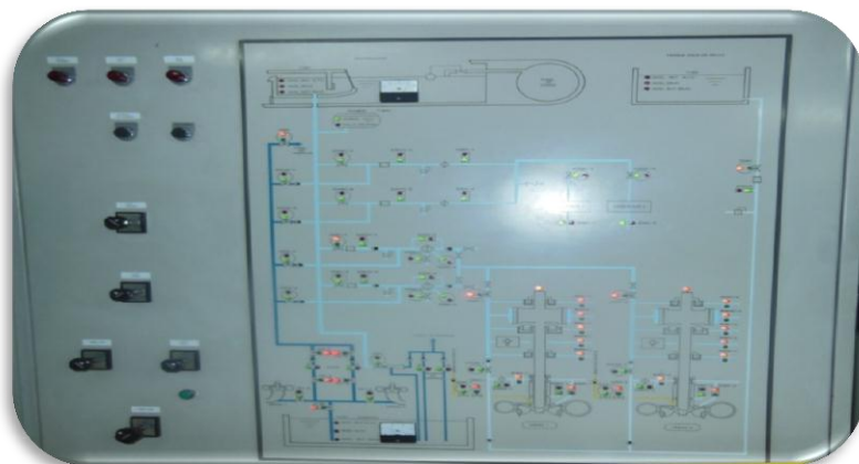
Figura 4.45: Tablero de control del sistema de drenaje.
