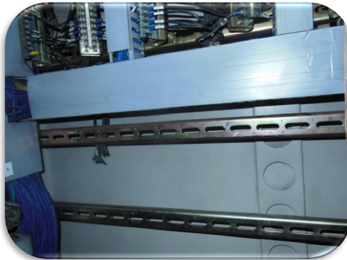
Figura 4.50: Rack para la instalación del PLC.
