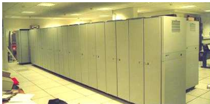
Figura 29. CENTRAL TELEFÓNICA ACTUAL
