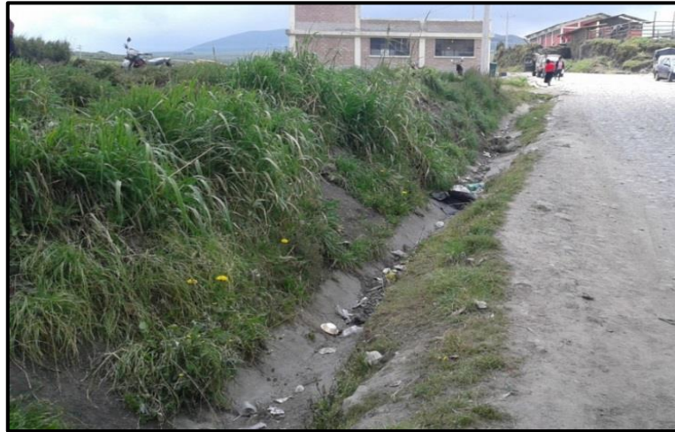
Imagen N°2: Drenaje vial deficiente
