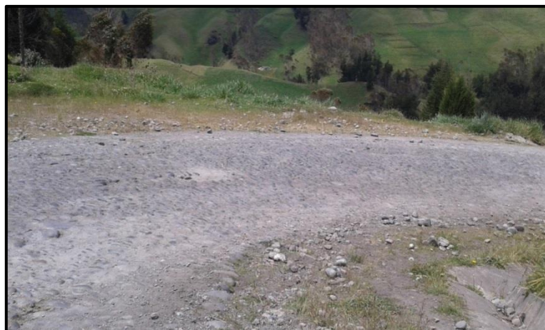
Imagen N°3: Mal estado de la vía.
