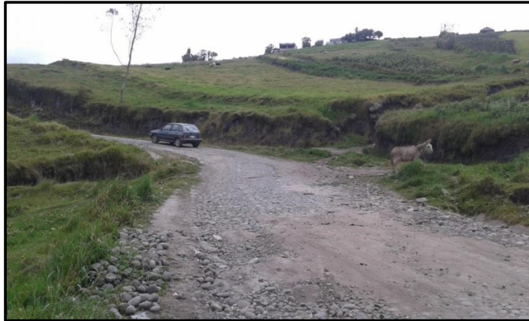
Imagen N°5: Deterioro de la capa de rodadura.
