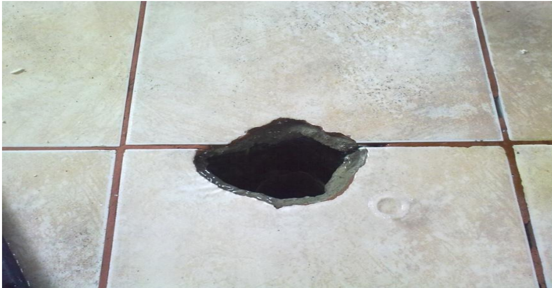
Figura N° 14 Drenaje de la sala de producción de quesos
