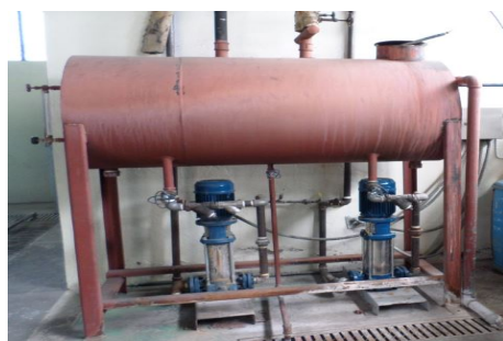
Figura 13: Tanque de condensado.
