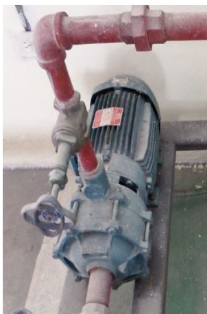
Figura 8: Bomba de recirculación.
