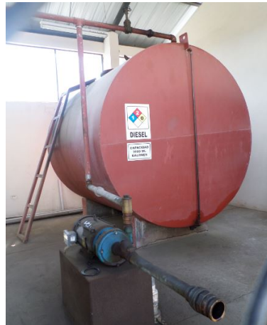
Figura 11: Tanque de almacenamiento de diesel.
