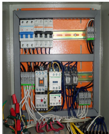
Figura 57: Cableado del circuito de potencia.
