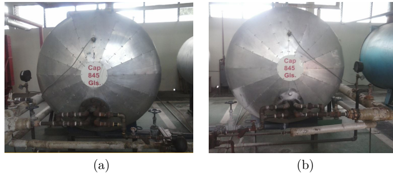
Figura 6: Intercambiadores de calor.
