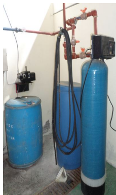
Figura 10: Sistema de ablandamiento de agua.
