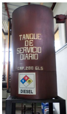
Figura 12: Tanque de servicio diario.
