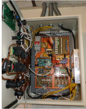
Figura 56: Cableado del circuito de control.
