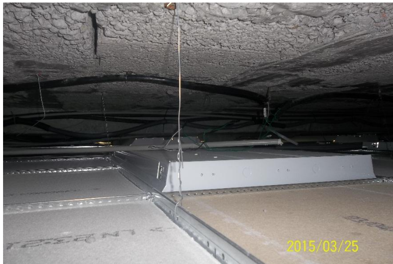
Fig. 4. 21 Cableado Eléctrico protegido por mangueras Fuente: Investigador
