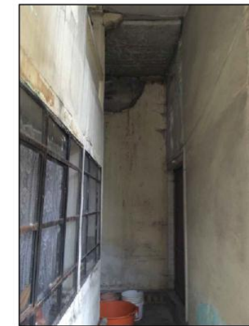
Desmoronamiento de paredes
