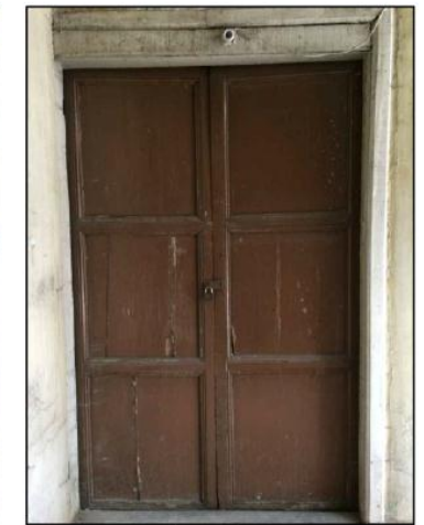
Deterioro de puertas
