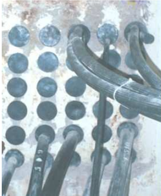
Figura 16. DUCTOS EN LAS CÁMARAS TELEFÓNICAS
