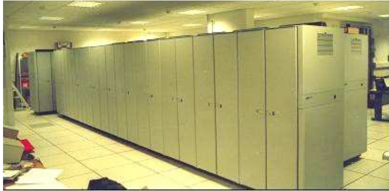
Figura 2. CENTRAL TELEFÓNICA ACTUAL
