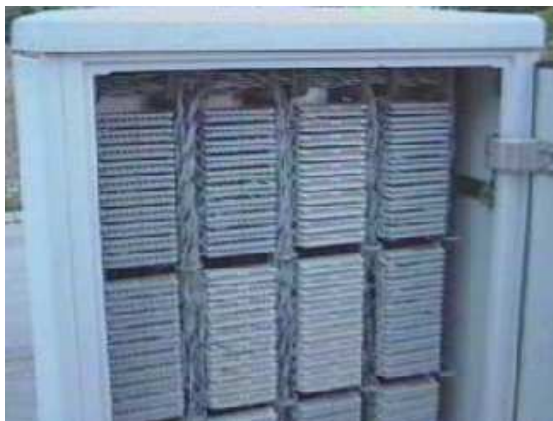
Figura 8. ESTRUCTURA FÍSICA DE UN ARMARIO CON SUS REGLETAS.
