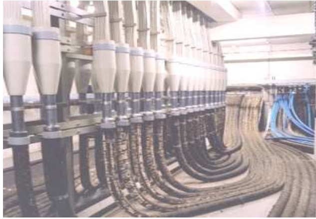
Figura 4. GALERÍA DE CABLES
