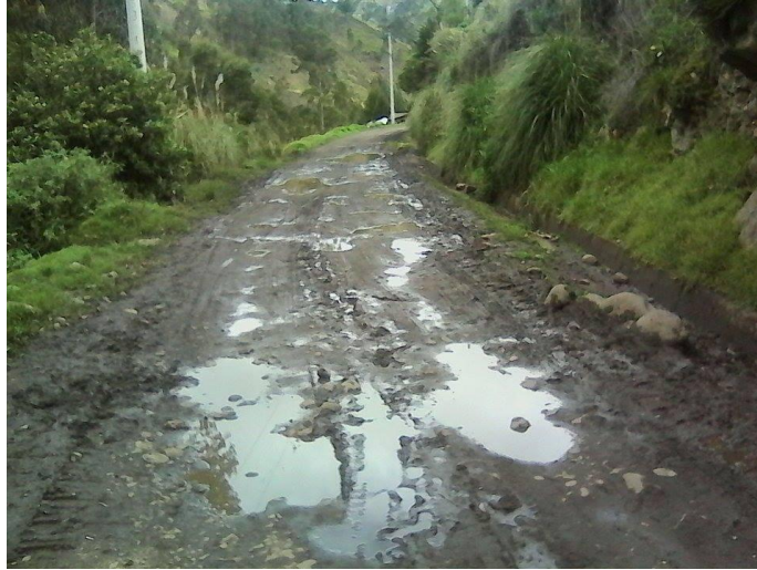
Vía en mal Estado
