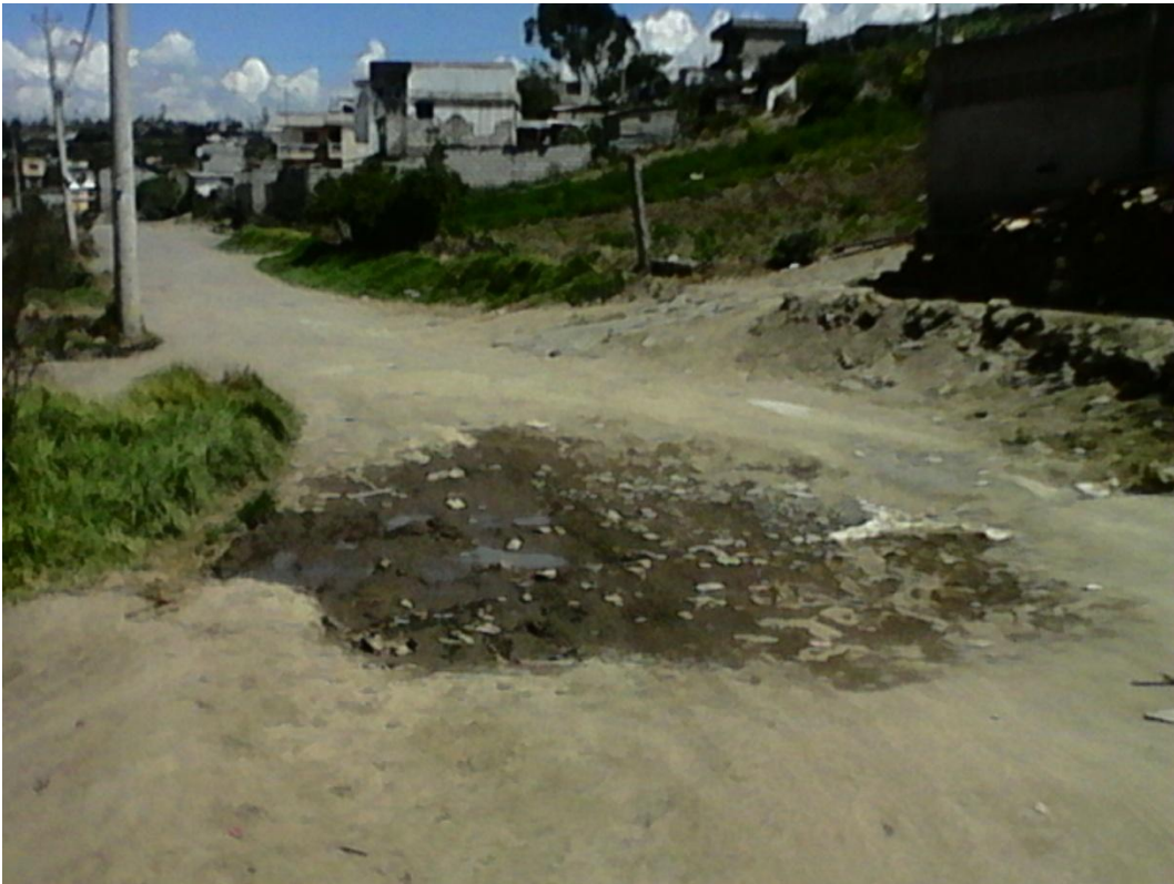
GRÁFICO N° 31 Capa de rodadura tipo lastrada en mal estado
