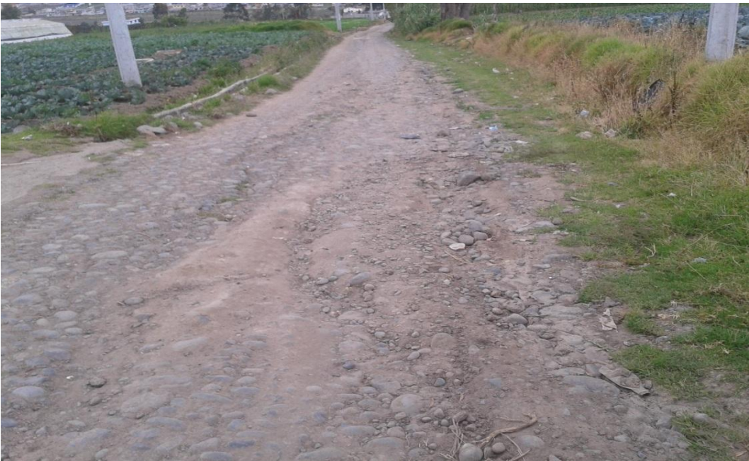
GRÁFICO N° 32 Capa de rodadura tipo empedrado en mal estado
