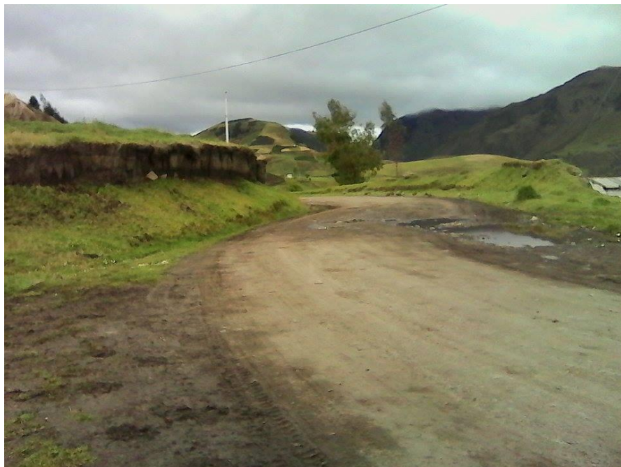
Estado actual de la vía km 3+300: condiciones de lastrado
