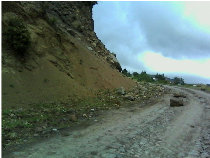
Estado actual de la vía km 4+100: condiciones de enpedrado y descenso de material de la peña
