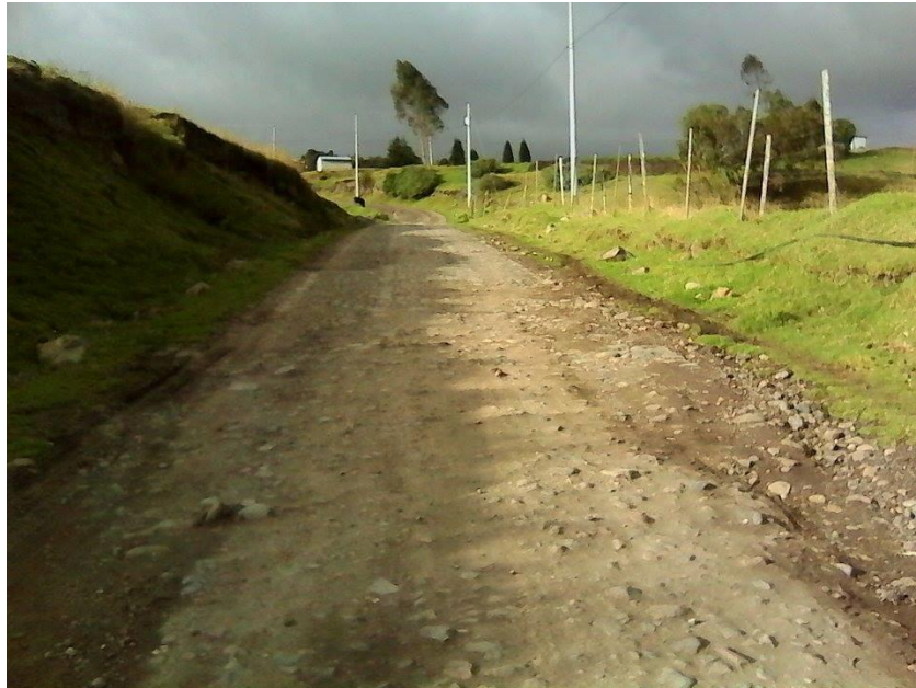
Estado actual de la vía km 3+550: condiciones de lastrado
