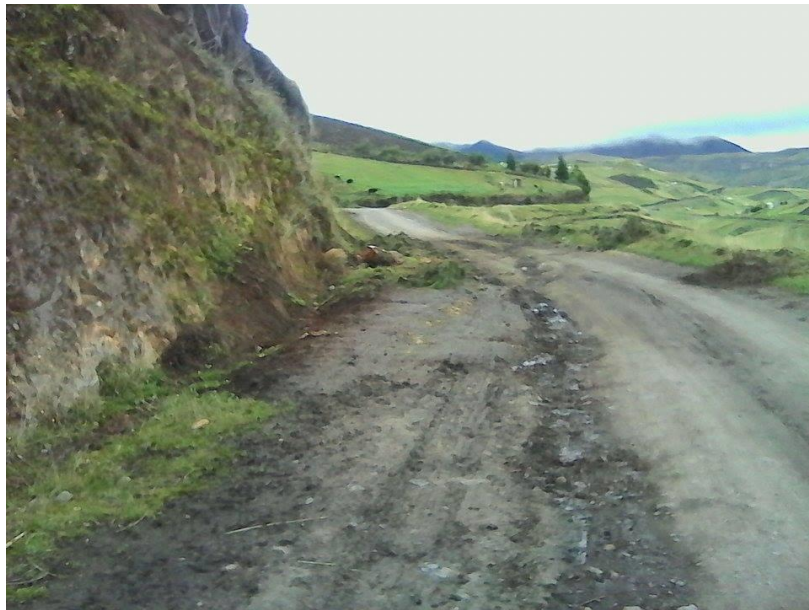
Estado actual de la vía km 2+100: condiciones del lastrado (malo)
