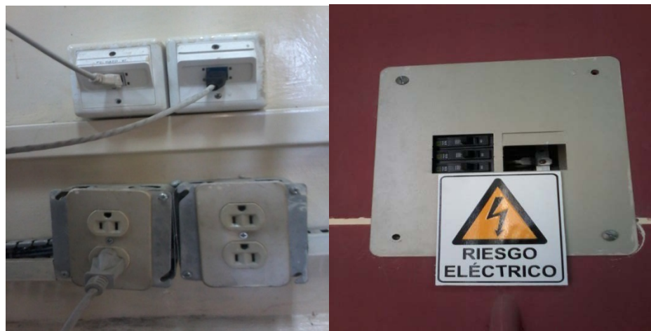
Fig. 4.68 Cableado y Conexiones
