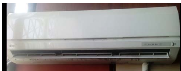
Fig. 4.59 Aire Acondicionado Cuarto de Equipos
