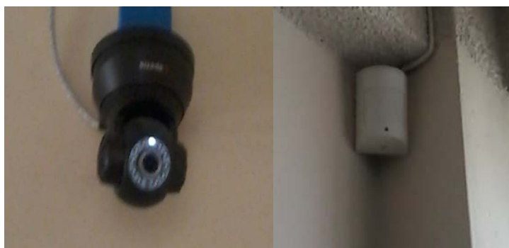
Fig. 4.69 Cámaras y Sensores de Movimiento
