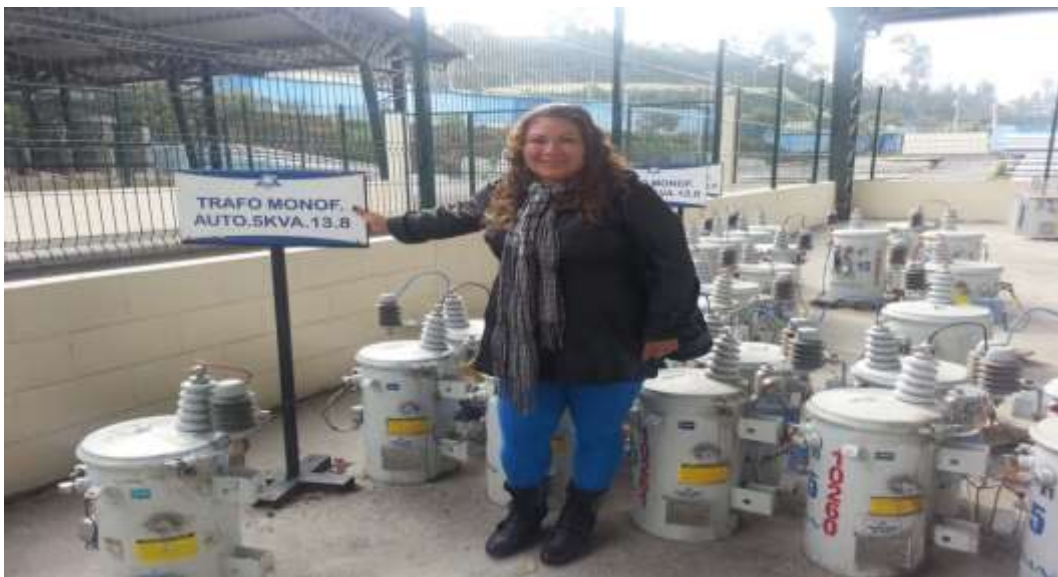
Transformadores monofásicos auto 5KVA. 13.8
