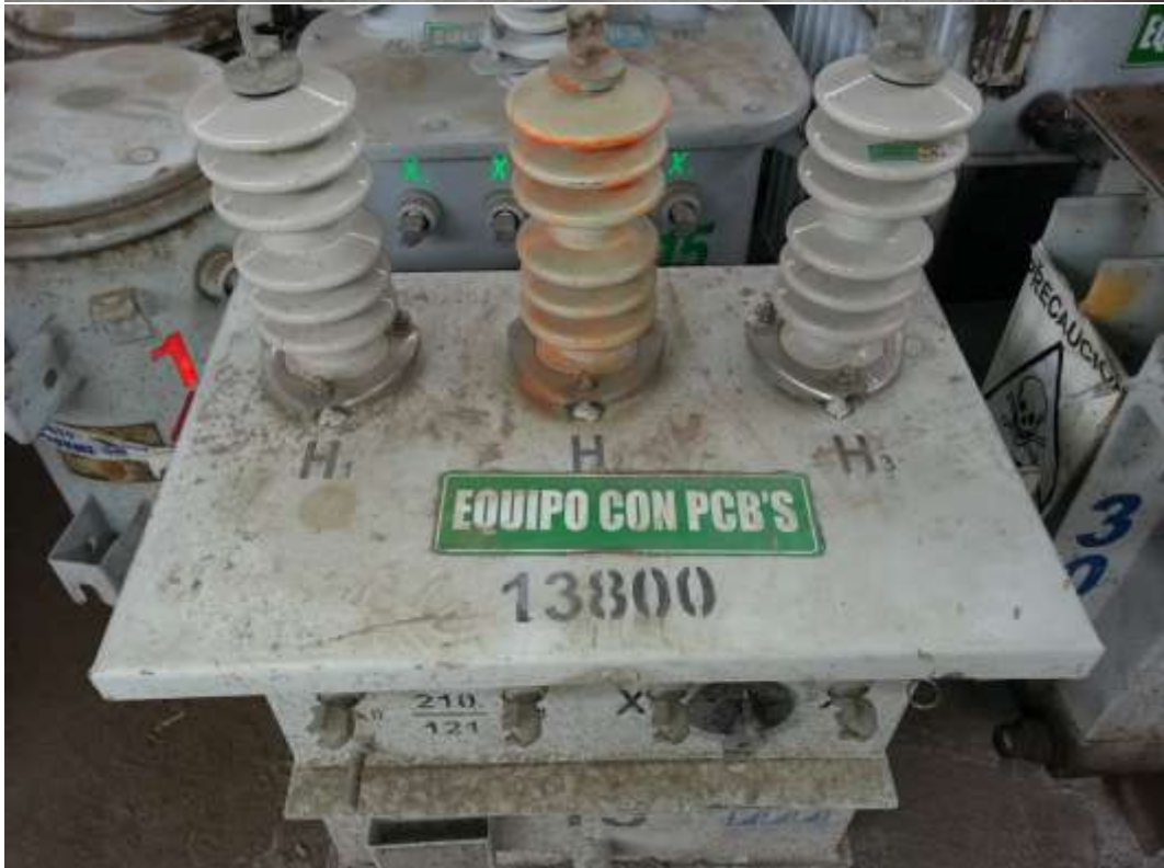
Transformadores con calificación 2 y PCB'S
