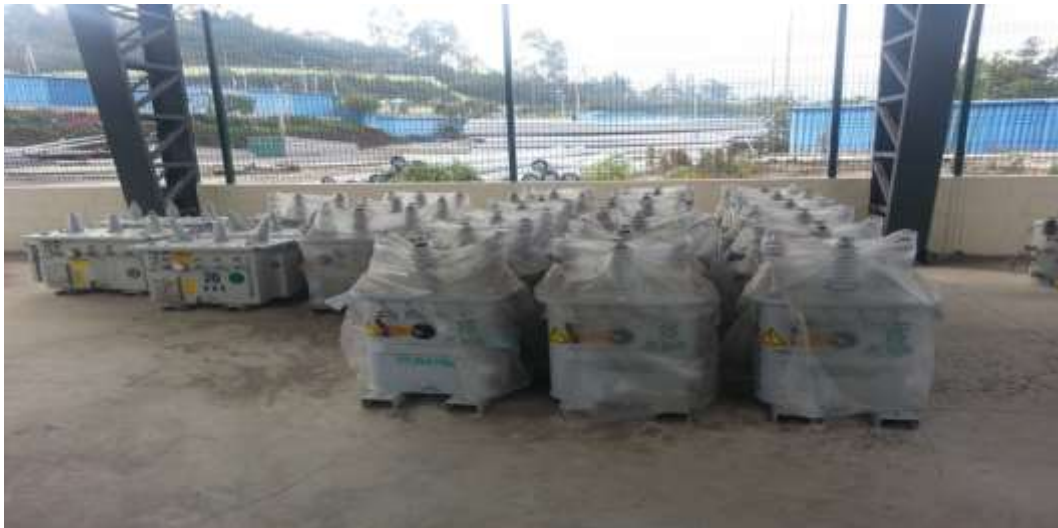
Transformadores trifásicos tipo DYN-5 (Marca EQUATRAN)
