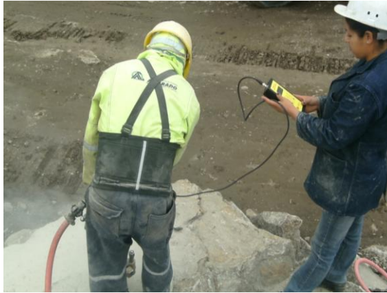
Figura.4.5: Medición Biodinámica de Mano-Brazo (Operador del Compresor).
