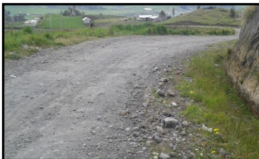
Presencia de baches
