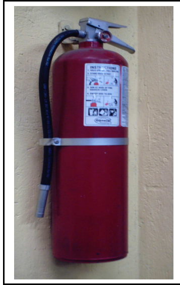
Figura 92. Extintor con polvo químico seco ABC de 9Kg.
