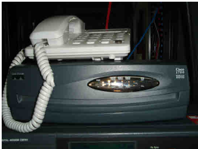
Figura 4.43 Router Cisco y Teléfono
