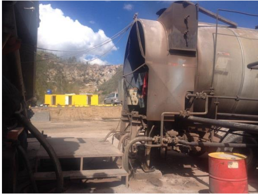
Fotografía 8 Caldero de calentamiento de materiales
