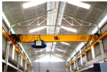
Figura 2-9 Grúa tipo puente
