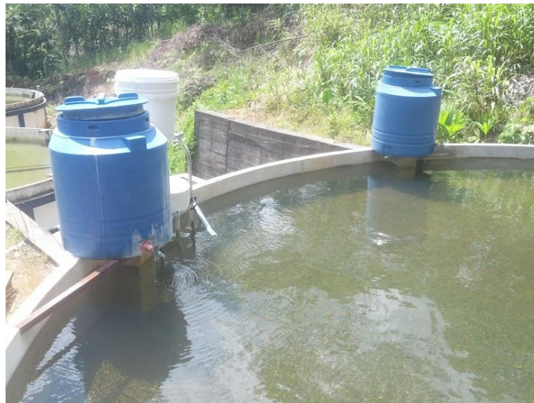
Filtro rápido de grava
