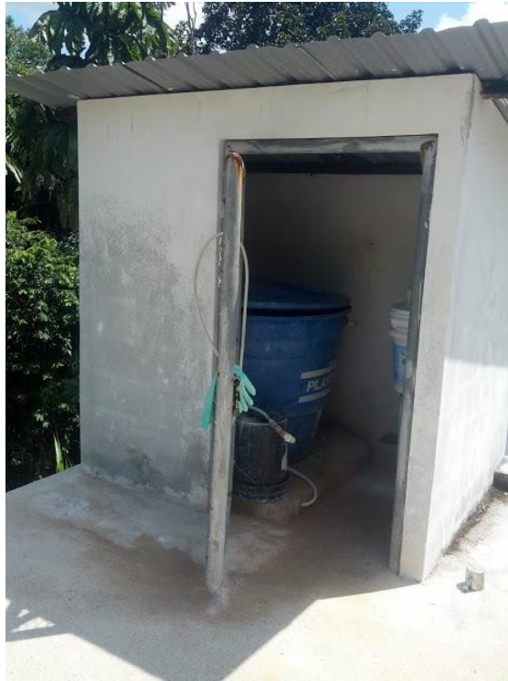
Tanque de clorado
