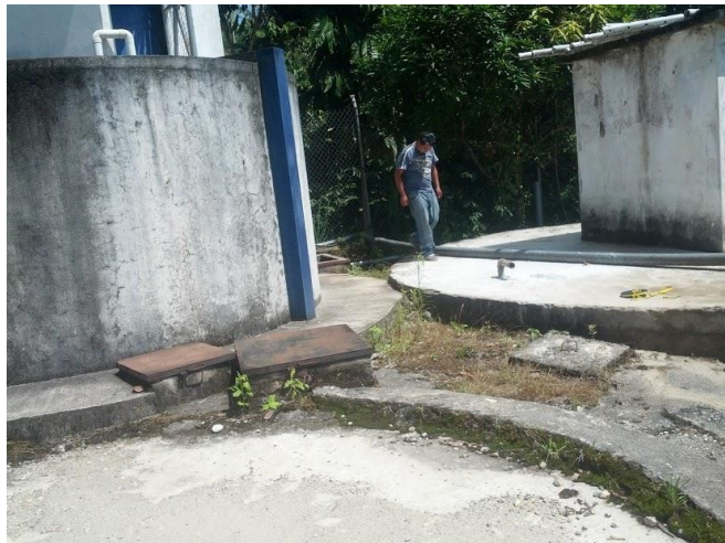
Tanques de almacenamiento
