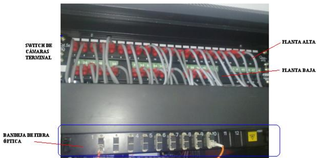
Figura No 47. Rack de Equipos.
