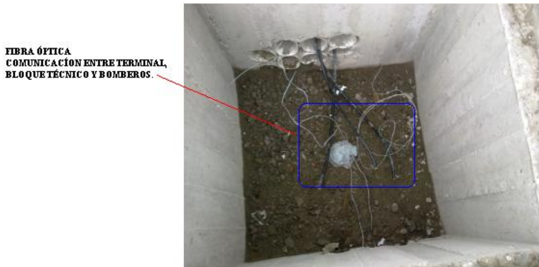
Figura No 58. Fibra óptica para la comunicación entre los distintos departamentos. Fuente: Investigador
