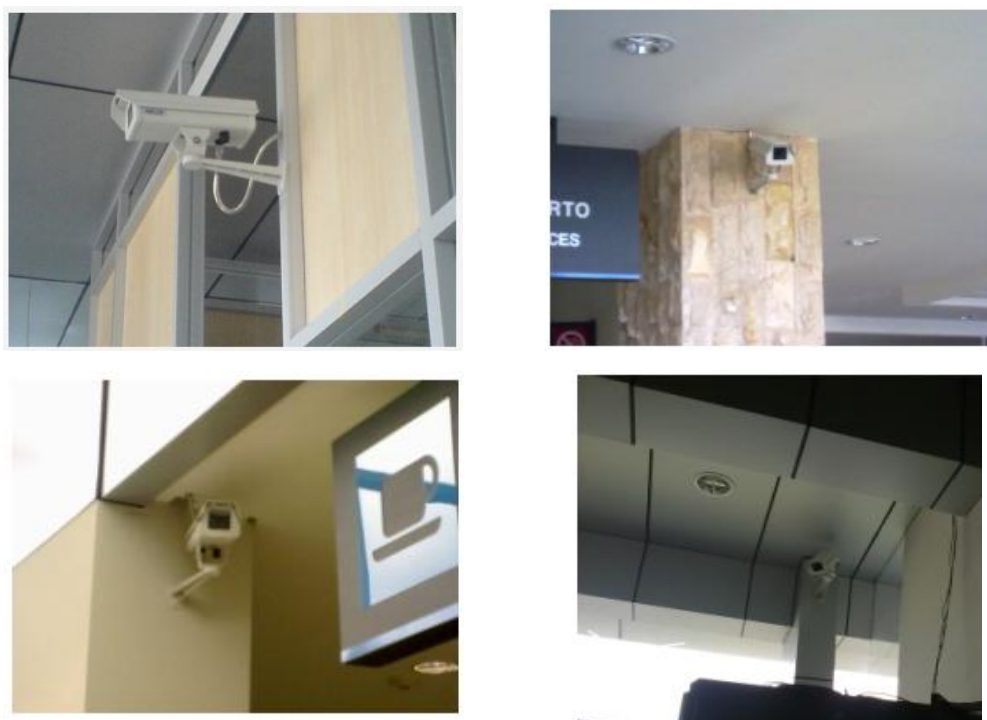
Figura No 56. Cámaras fijas en el interior del Aeropuerto.
