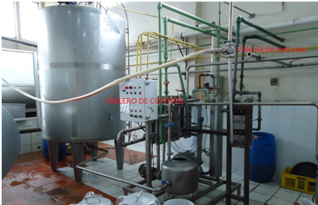
Ilustración 28: Pasteurizado de leche
