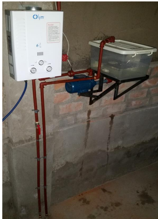
Figura 3. 38 Sistema de impulsión y calentamiento completo
