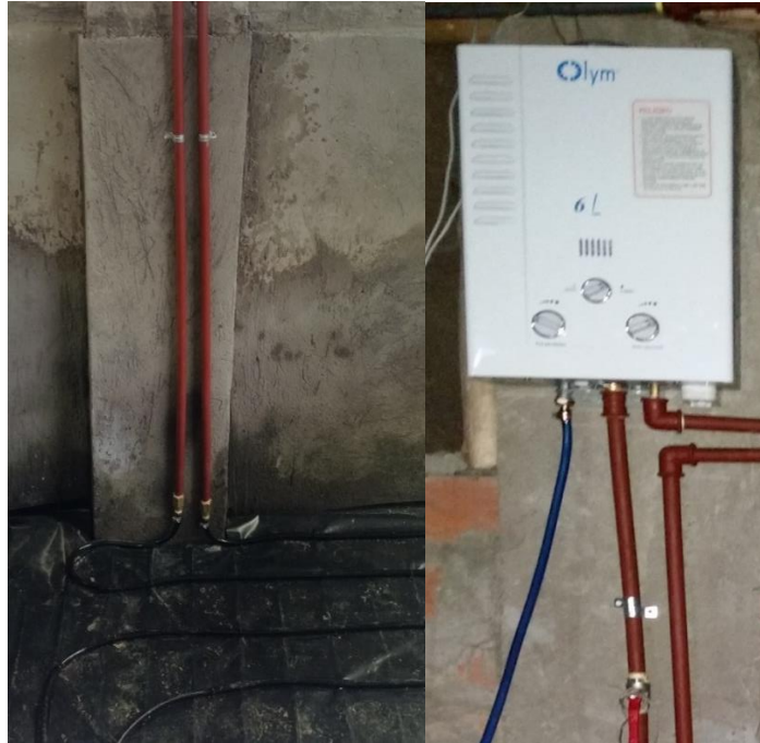
Figura 3. 30 Tubería de entrada, salida y calefacción de agua
