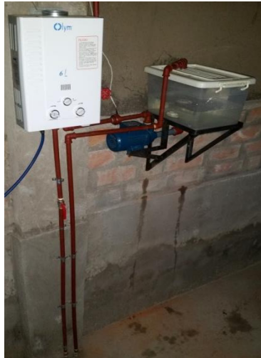
Figura 3 Sistema de impulsión y calentamiento
