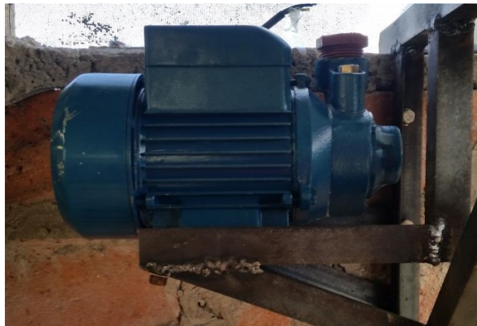
Figura 3. 33 Bomba de agua
