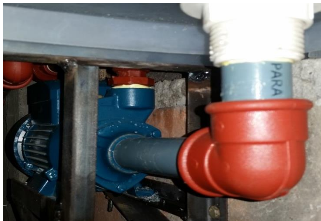
Figura 3. 35 Tubería de succión
