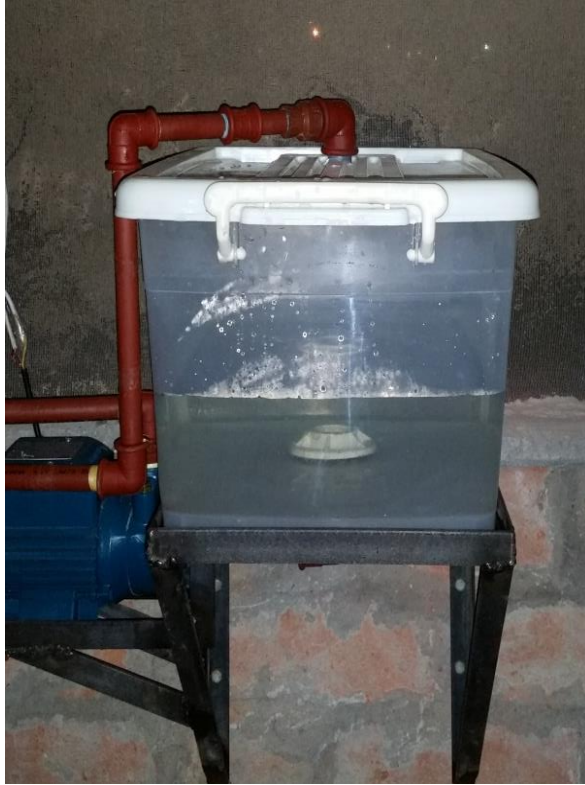
Figura 3. 37 Tubería de descarga a tanque de almacenamiento
