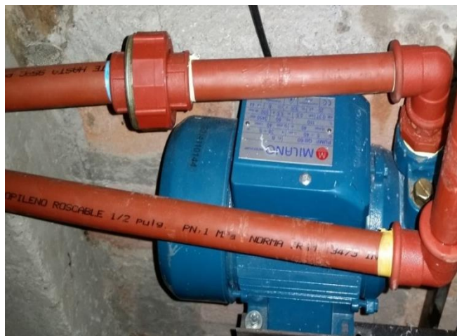
Figura 3. 36 Tubería de descarga de la bomba
