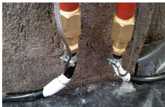
Figura 3. 31 Medidores de temperatura entrada y salida de serpentín
