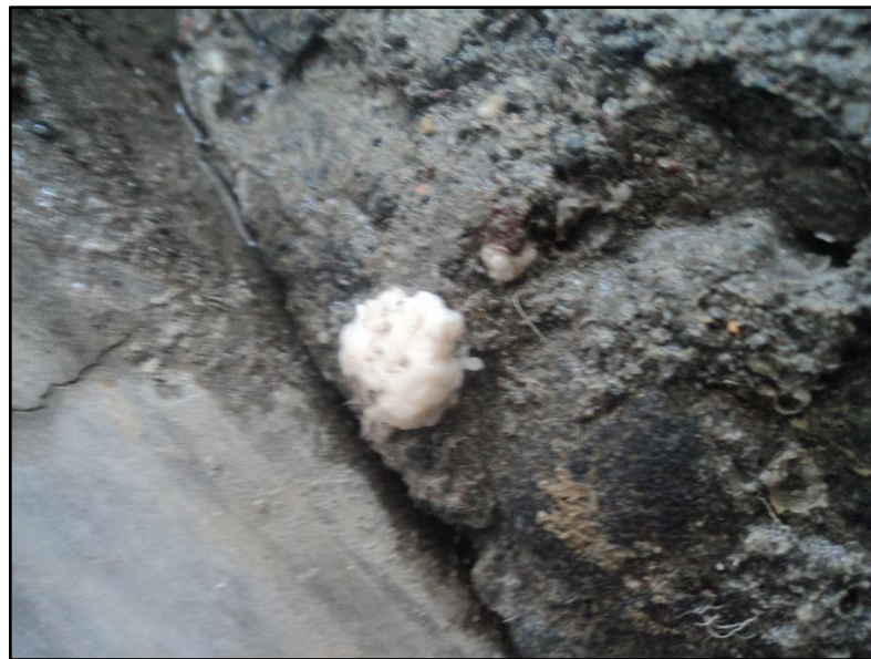
Probeta de hormigón con fibras de algodón vistas. Luego de sacar del curado las probetas hechas con fibra de lana y algodón, se evidenció que, el ácido esteárico al ser expuesto en agua, su material sólido fue transformando en una masa blanda con textura muy parecida a un jabón.
