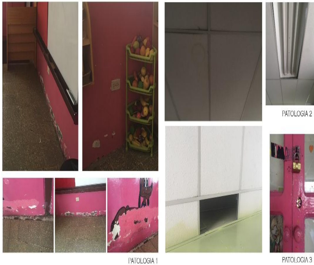
Imagen No. 28: Patologías - Unidad Educativa "Rumiñahui" Fuente: Castillo, A (2016)
