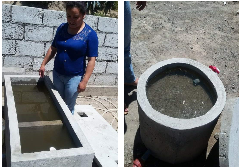
Foto N° 13.- Agua residual despues del tiempo de retención asumido para el Tanque Séptico y Filtro Biológico respectivamente.
