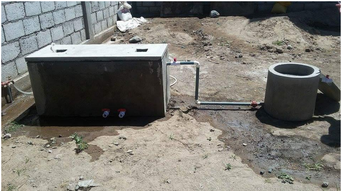
Foto N° 7.- Unidades del Sistema de tratamiento de aguas residuales.
