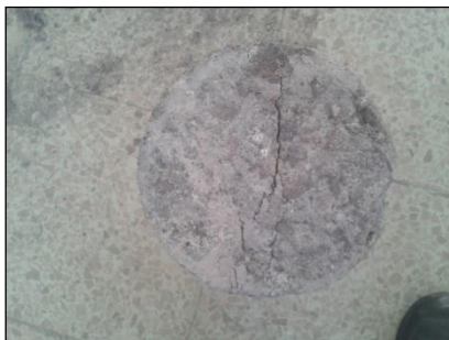
Fotografía N° 35. Falla Tracción Normal
