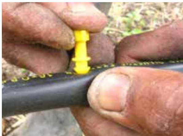
Fig. 3-3 Instalación Micro Jet II
