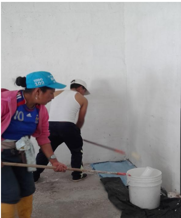
ANTES SIN PINTURA EPOXICA
