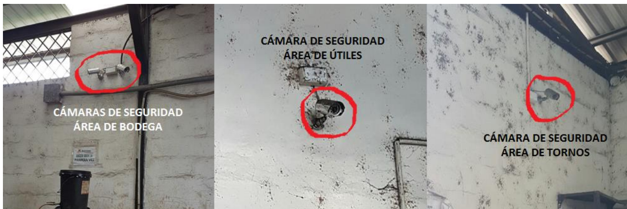
Figura 4. 6: Cámaras de seguridad.
