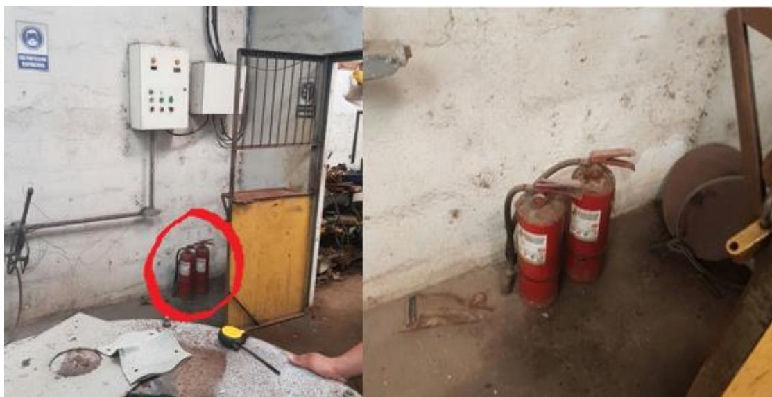
Figura 4. 7: Extintores en una mala ubicación
