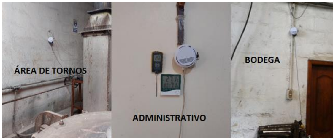
Figura 4. 40: Colocación de los sensores de temperatura y detectores de humo en el área de tornos, Administrativo y Bodega de la empresa ACETERM
