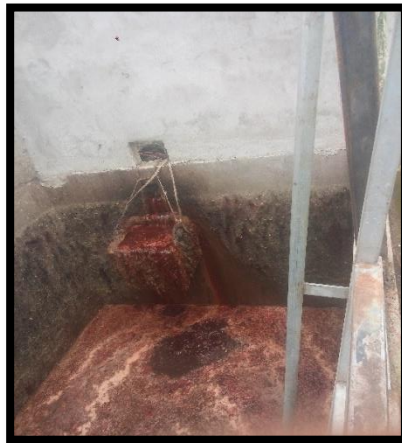
Fotografía 5. Tanque de almacenamiento de agua residual.
