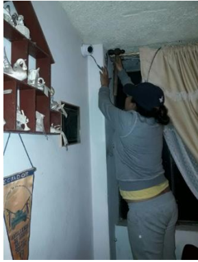
Figura D14. Colocación de Cámaras
