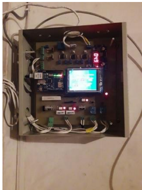
Figura D15. Sistema instalado
