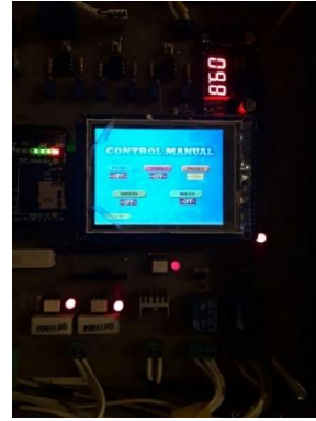
Figura D17. Sistema instalado
