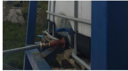
Foto 14. Llave de control de caudal (entrada) .
