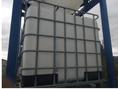
Foto 13. Tanque de almacenamiento de agua residual.
