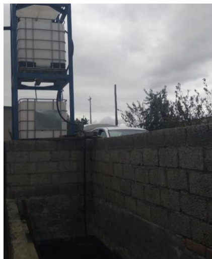
Foto 17. Sistema de bombeo.
