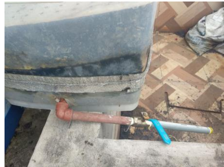
Foto 16. Llave de control de caudal (salida) .
