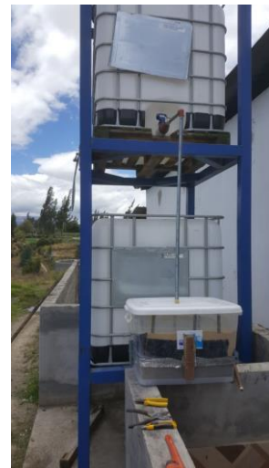
Foto 18. Estructura del filtro biológico.
