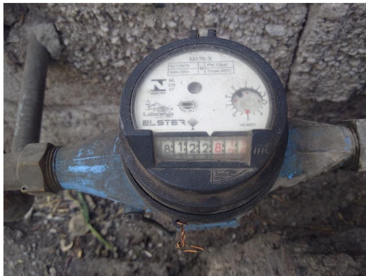
Medidor de Agua.
