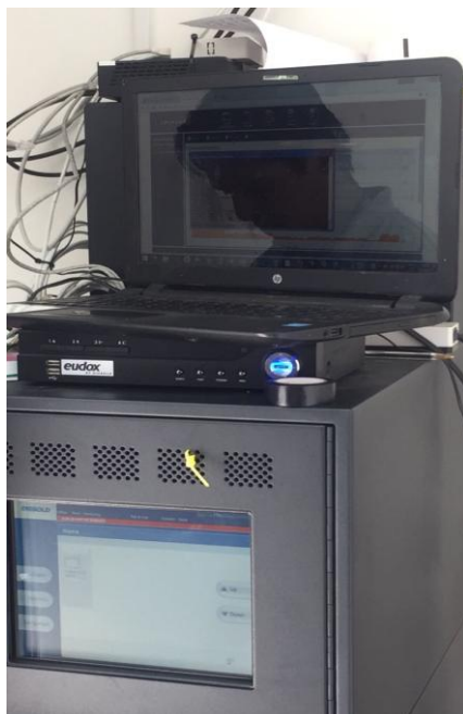
Figura 41. Pruebas de enlace realizadas en el ATM CHIMBO Elaborado por: El Autor
