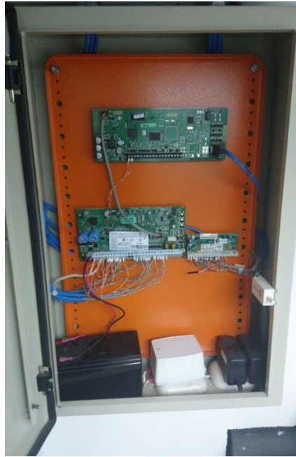
Figura 9. Gabinete de Alarmas Elaborado por: El Autor
