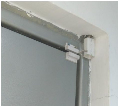
Figura 10. Contacto Magnético en la Puerta de Ingreso Elaborado por: El Autor
