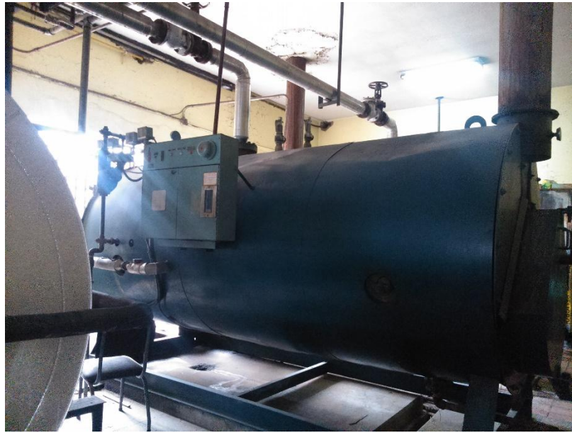
Figura 12: Vista posterior Caldero Hospital Regional Docente de Ambato
