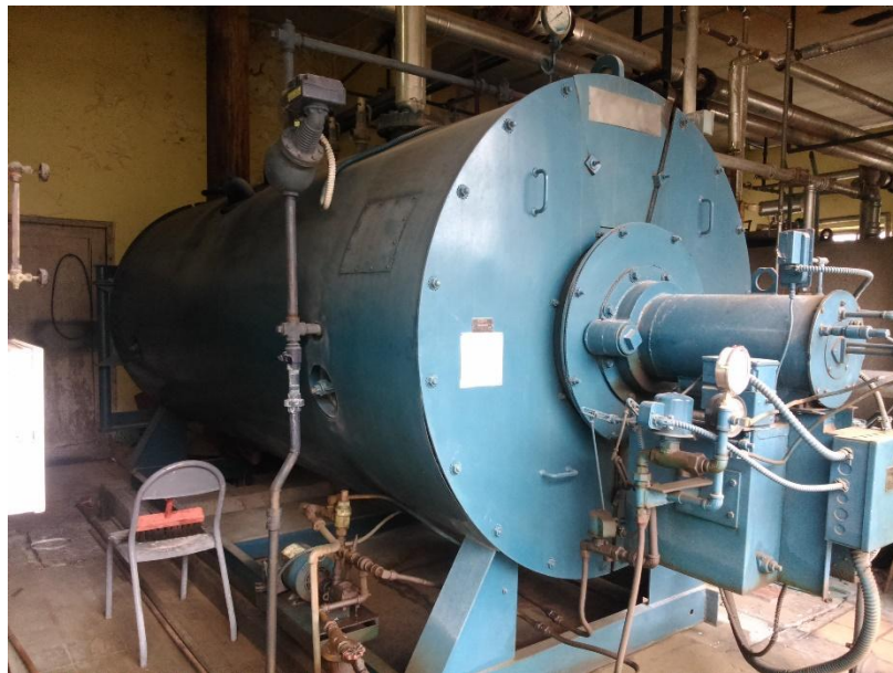
Figura 11: Vista Frontal Caldero Hospital Regional Docente de Ambato
