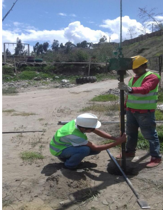
Fotografía 1. Marcando la altura de hincamiento de la barra de acero cada 15cm
